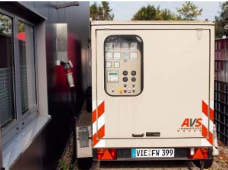
Fahrbare Notstromgeneratoren halten bei fehlender Stromversorgung den Betriebsablauf aufrecht. Foto: Feuerwehr Willich
