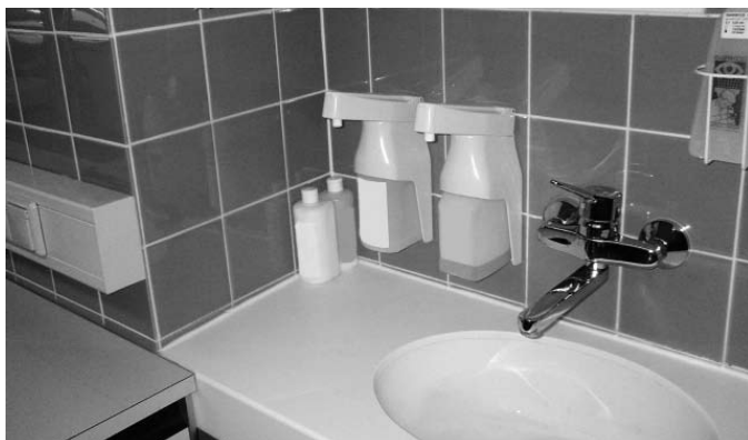
Beispiel eines Händewaschplatzes (Hinweis: Auswahl zufällig; auch vergleichbare Desinfektionsmittelpender und Einhebel-Armaturen sind geeignet).
